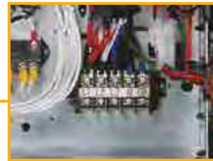
Dış ünite güç besleme terminal bloğu
